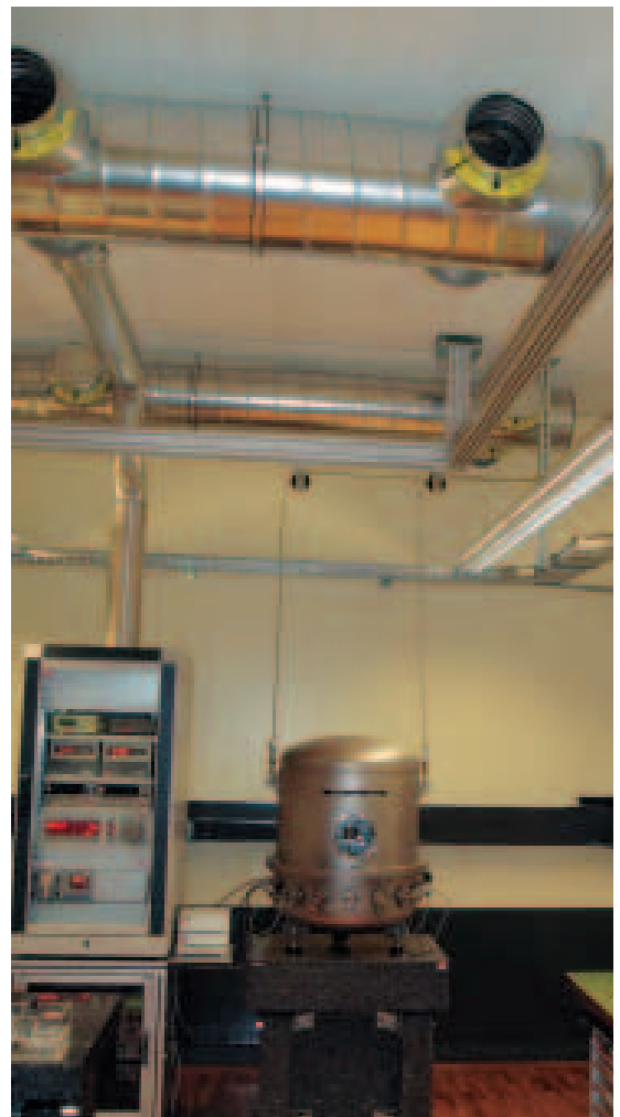
Installations de laboratoire avec système de support plafonnier
